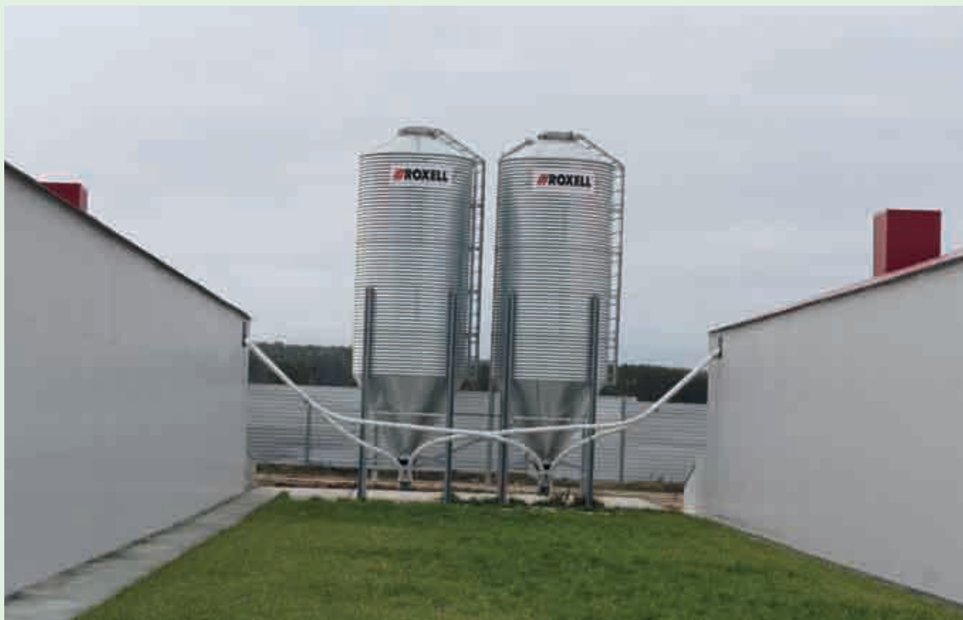
Из силосов комбикорм автоматически подается в кормушки кроликам
